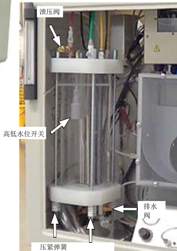
安装好的鼓泡塔
