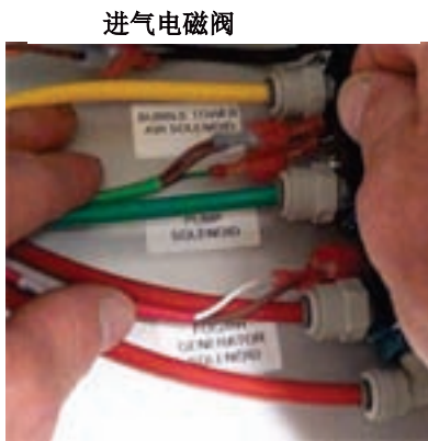
从上至下: 鼓泡塔空气电磁阀, 喷淋泵电磁阀和喷雾/控湿电磁阀
