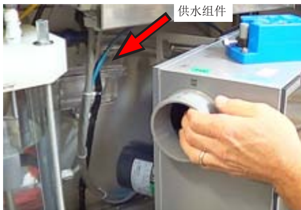
9. 在鼓风模块背后的墙上有供水组件。
